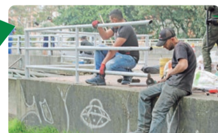
La empresa Ivesur se unió al trabajo de embellecimiento del puente con su equipo técnico y humano de soldadura, reemplazando y ajustando barandas para dejarlas como nuevas.
